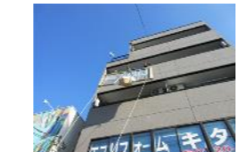
商材が大きくて階段室からの搬入が困難な為、ベランダから吊り上げて搬入。
